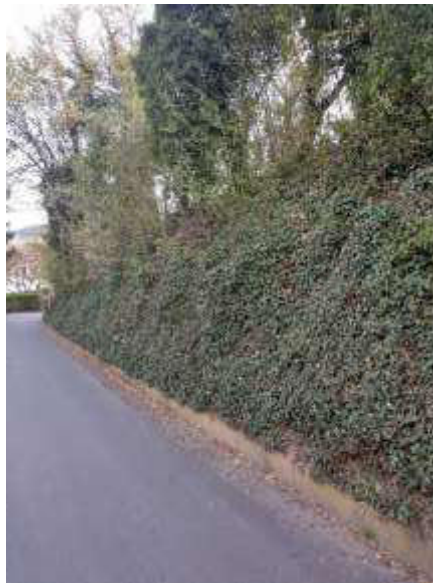
Abb3 von Efeu überwucherte Böschung
